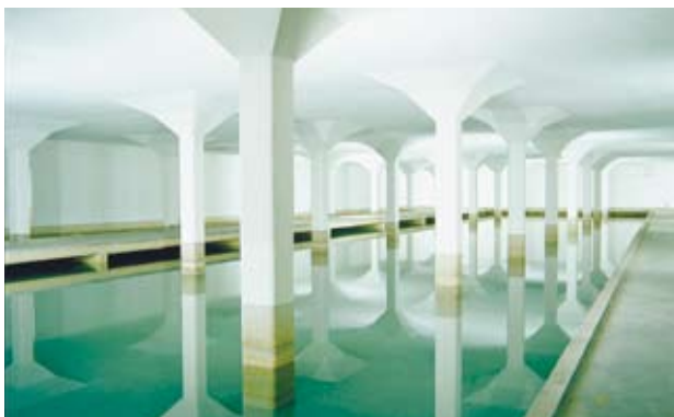
Sandfilteranlage einer klassischen Seewasseraufbereitung, Bildquelle: Wasserversorgung Zürich
