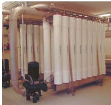
Moderne Membranfilteranlage in Lausanne, Bildquelle: eauservice Lausanne
