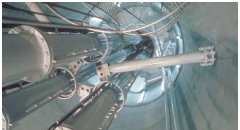
Blick in einen Grundwasserbrunnen, Bildquelle: Wasserversorgung Zürich
